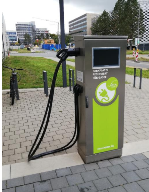
Abbildung 2.99: Ladesäule an der ETA-Fabrik inkl. DC-Ladepunkten.
